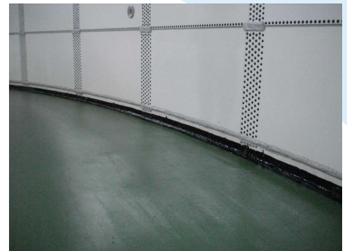
Interior de Almacenamiento de Agua Municipal XL Anillo de Ajuste con la Parte Inferior de Concreto
