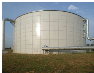
Almacenamiento de Agua Potable
